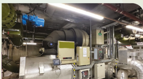
機電署為屯門醫院主座更換的高效能空調製冷機組。
